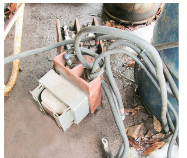
落雷によって破損したVT(計器用変圧器)。
