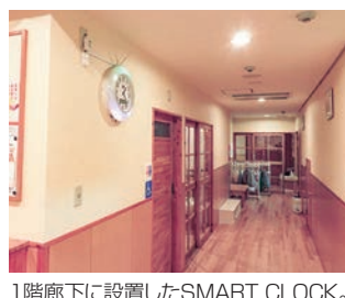
1階廊下に設置したSMART CLOCK。
